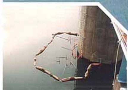
取水塔円形スクリーン修繕前
